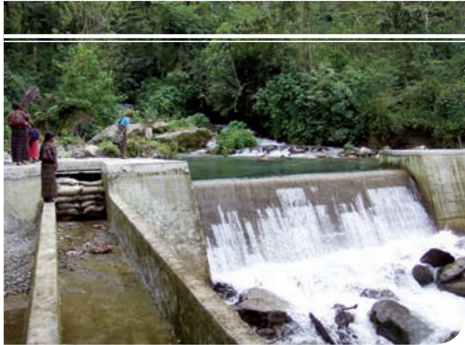
Micro-hydro dam. Fundación Solar Guatemala.
